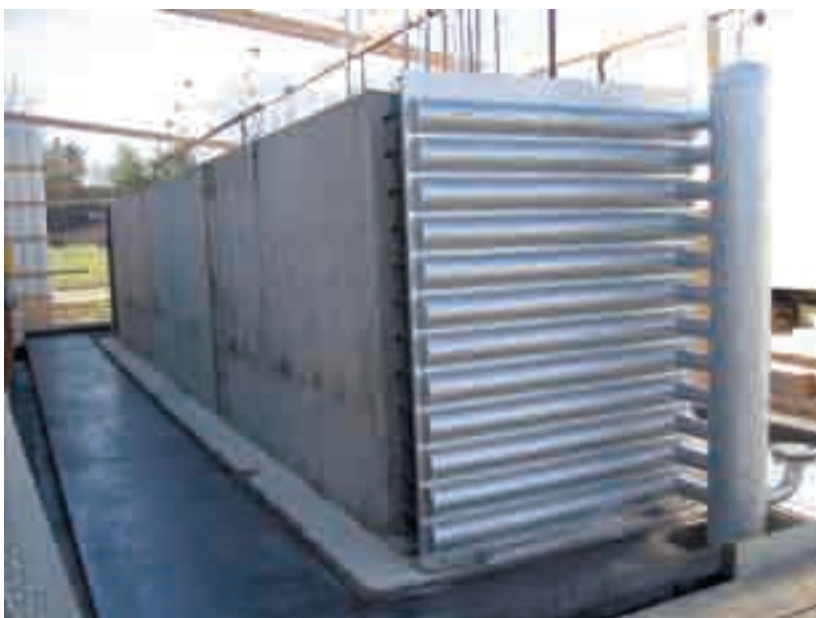
Foto 1. Sistema de almacenamiento térmico en hormigón con registro de tubos del intercambiador de calor. Fuente: http://presseservice.region-stuttgart.de/detail/289581 .
