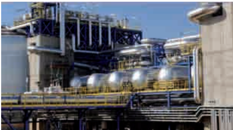
Foto1. Intercambiadores en la planta Andasol I.
