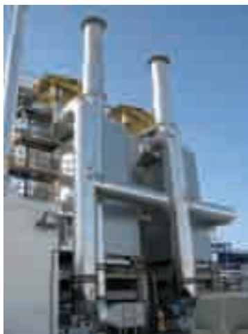
Foto 12. Caldera de gas natural en una central termosolar. Fuente: Archivo RENOVETEC.
