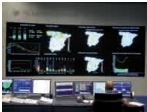
Foto 3. Centro de Control Eléctrico de Régimen Especial (CECRE) de Red Eléctrica de España. Fuente: REE.
