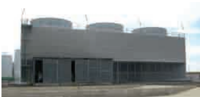
Foto 5. Torre de refrigeración. Fuente: Archivo RENOVETEC.
