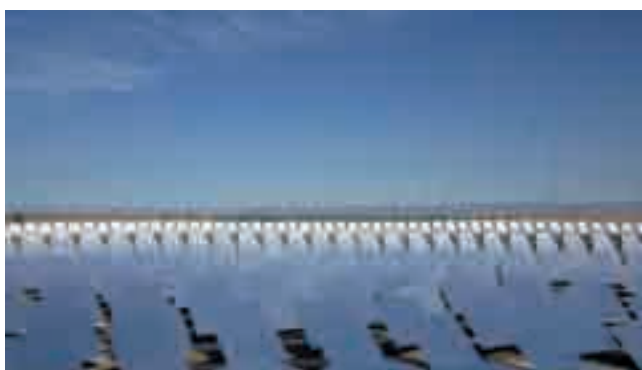
Foto 3. Campo de heliostatos en operación.
