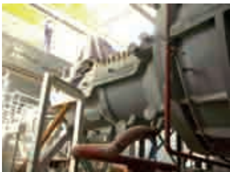
Foto 4. Turbina de vapor. Fuente: Archivo RENOVETEC.
