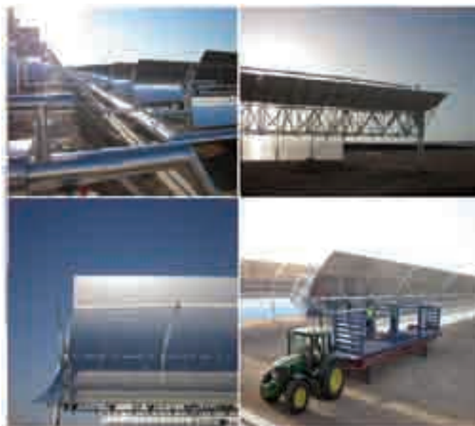
Foto 2. Tuberías y juntas rotativas, estructura captador, espejos y receptores de las CST. Fuente: Astexol 2, 2011.
