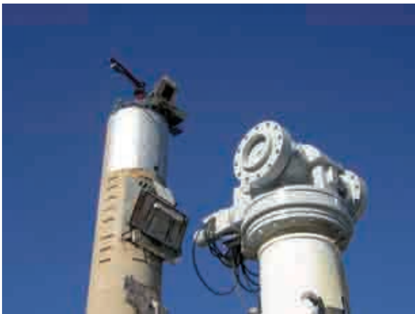
Foto 2. Mecanismo de apunte de alta precisión de SENER instalado en la planta CESA I de la PSA.
