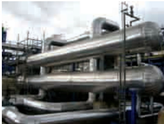
Foto 3. Intercambiadores del tren de generación de vapor. Fuente: Archivo Renovetec.
