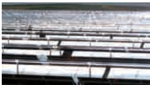
Foto 2. El campo solar en una central CCP. Fuente: Archivo RENOVETEC.
