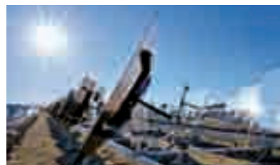
Detalle del campo de heliostatos
